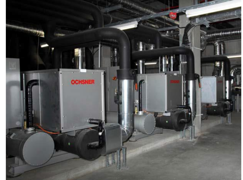
Großwärmepumpen 3 Stk. je 500 kW th
