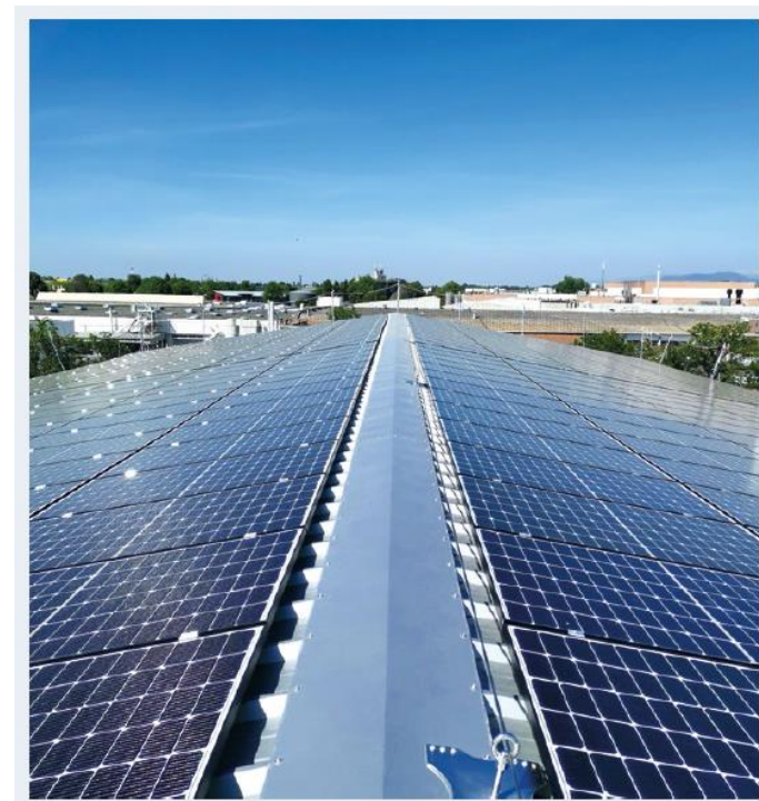
Quelle: Auszug aus © Solar Cluster BW 2021 – Leitfaden „Photovoltaik in Gewerbe und Industrie“; Quelle Foto - focusEnergie GmbH & Co. KG
